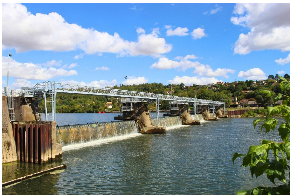
Barrage de Couzon-au-Mont-d'Or ©Enogrid
